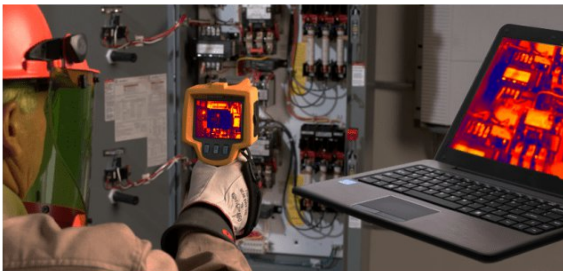
Рисунок 20. Пример проведения тепловизионного контроля электрошкафа
